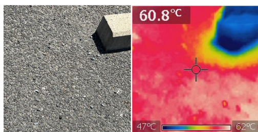
アスファルトの温度は60℃超え
