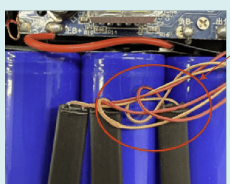
プラスマイナスの導線が絡んでいる(ショートの状態あり)
