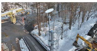
北海道内にて渡島トンネル(上二股)工区(発注者:JR TT、施工者:清水建設株式会社)の工事現場に設置された「Satellite Mobile Link」のau基地局
