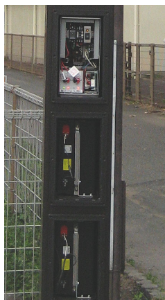
装置の内部にはPHSモジュールが設置されており、独自開発された省電力回路が用いられている
