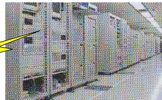
データセンター
